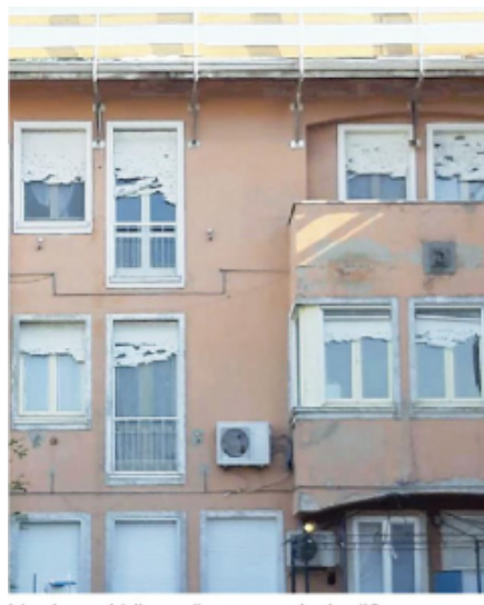
I danni causati dalla grandinata a una palazzina di Gonzaga
